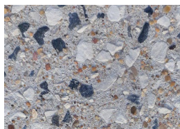
Béton érodé (Square Voas Glaz)
