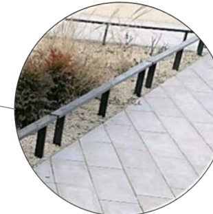
Lisse de protection en acier
